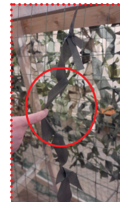
Отсутствие закрепления ленты к основе
